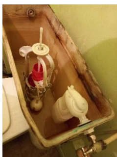
Changement de notre chasse d'eau WC
